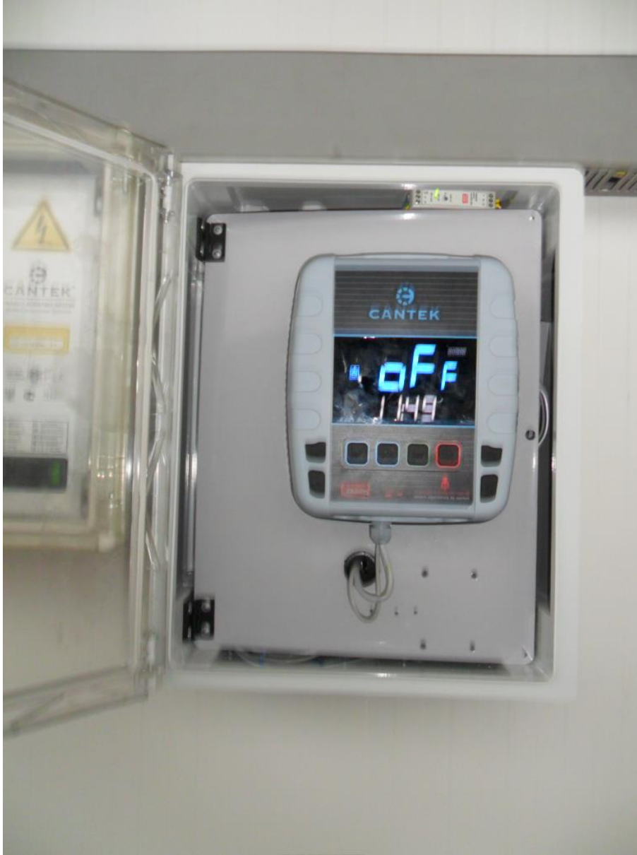
FOTOĞRAF-6) TEST ODASINA BAĞLI OCTOSENSE SOĞUK ODA KONTROLÖRÜ
